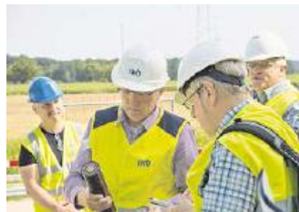
Dickes Kabel. Gregor Leonhardt, IWB, zeigt ein Stück Kabel, von dem total neun Kilometer verlegt werden.
