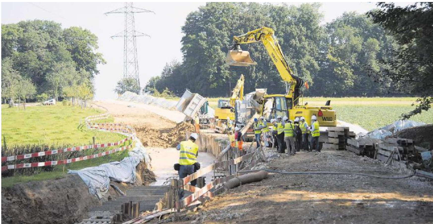
Bauen wie am Fliessband. Stromkabel werden mit Flüssigerde übergossen, und nach einem Tag trocknen kommt bereits die Humusschicht darauf. Fotos Stefan Leimer
