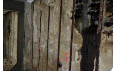
Die Anlage wies erhebliche Schäden auf.
