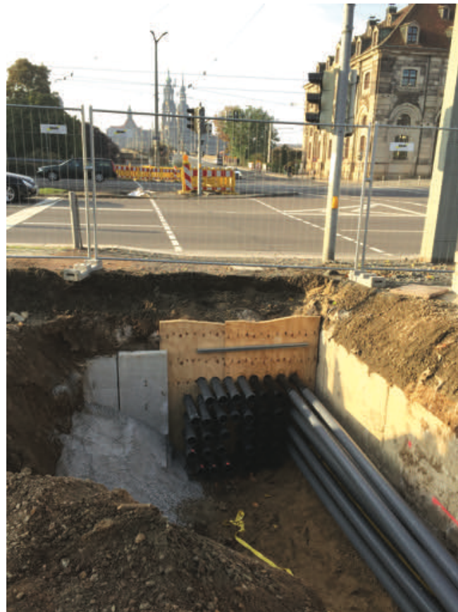
Im westlichen Bereich des Haupttunnels entstand eine großzügige Kabeltrasse. Foto: FiFB Leipzig
