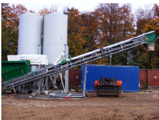
Die neue RSS-Kompaktanlage der Firma Meyer in Tuchtfeld.
